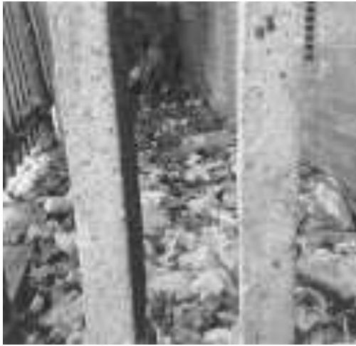
Sporcizia all'ex deposito postale
